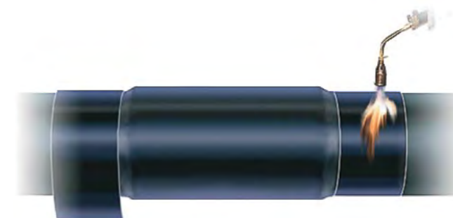
Рис. 12. Усадження кінців муфти здійснюється постійним плавним переміщенням слабкого полум'я газового пальника по діаметру з поступовим переміщенням його вздовж осі труби.
